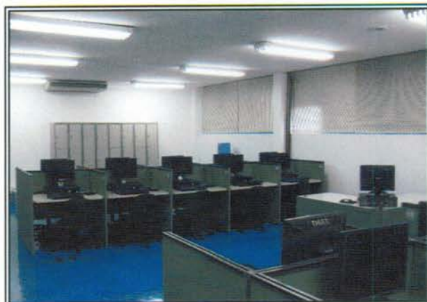
Supervisão/Central de Processamento de Dados
